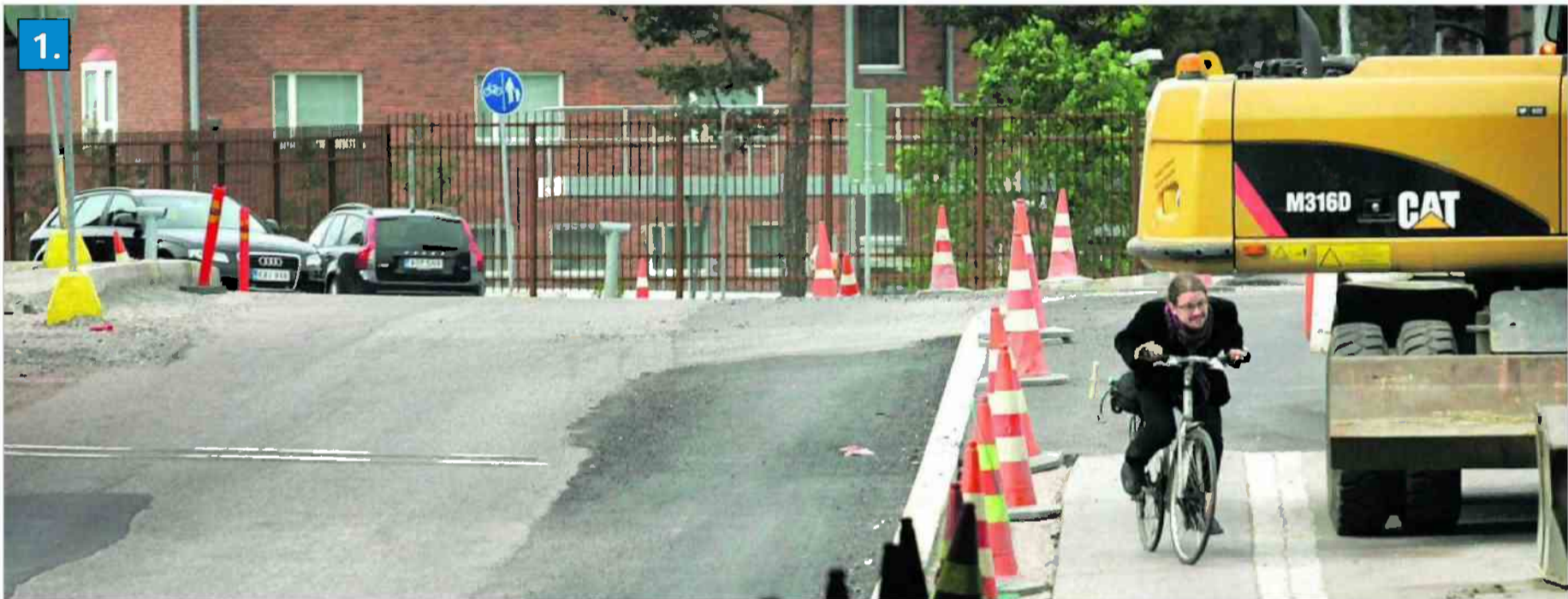
YLEINEN KAAOS. Länsiväylän alta kulkeva Salmisaarenkatu on metrotyömaan vuoksi täysin rempallaan. Alueen opaste- kyltit muuttuvat päivittäin, kiortoreitit ovat haastavia ja tien pinta paikoitellen vaarallisessa kunnossa. Otso Kivekäs joutui tiukkaan tilanteeseen.
